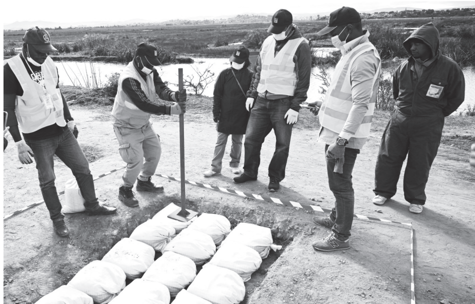
道路維持管理（E）コース・マダガスカルでの在外補完研修で土のうの締固めを行う研修員
