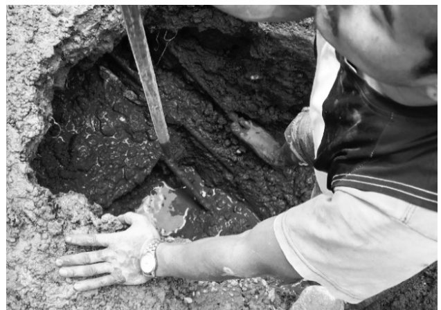
漏水発生場所
