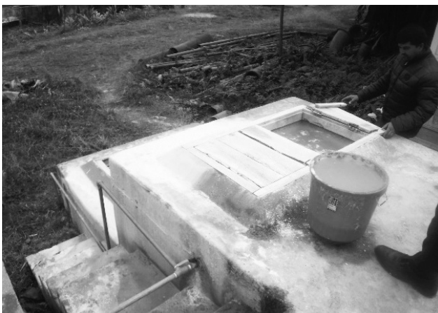
浄水場は無く、配水池でさらし粉（消毒剤）を入れて配水 （写真はさらし粉の溶解槽）
