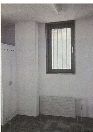
温水セントラルヒーティングでは窓下に低温輻射型のパネルを設置するのが基本
