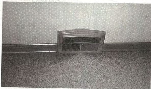
セントラルヒーティング温風暖房の吹き出し口
